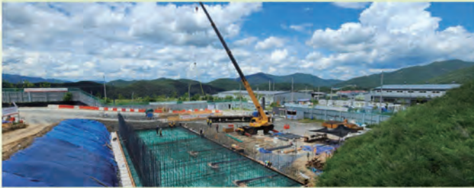
경주 명계산단 침출수 처리시설
